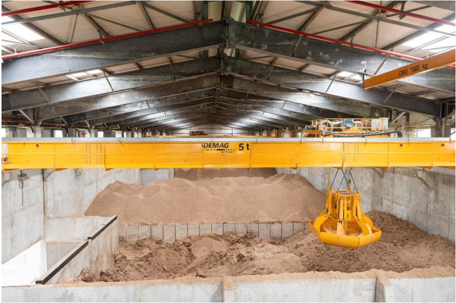
Puits de bagasse de la centrale Galion 2 © Albioma
